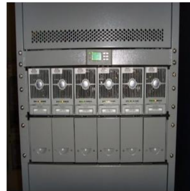
DC柜电源功率不足
